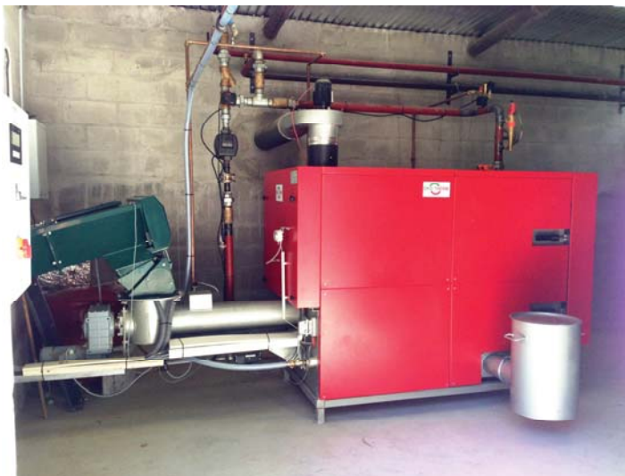
ÖKOTHERM®-Biomasse-Heizanlage mit 120 kW
