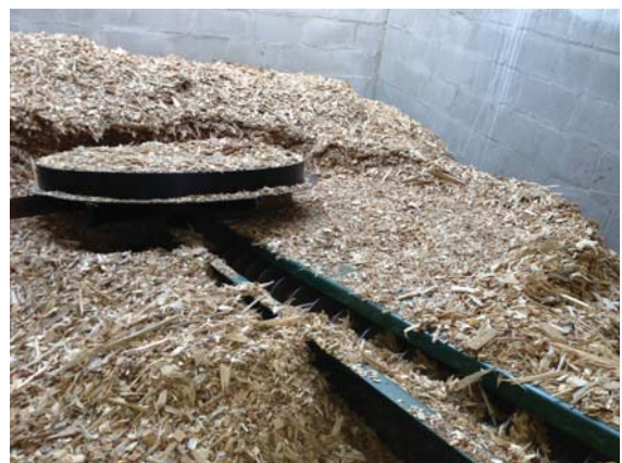
Brennstoffsilos mit Austragschnecke
