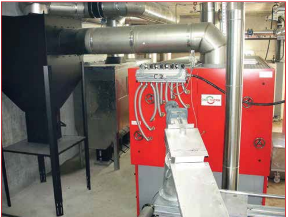
ÖKOTHERM® Typ C6, 800 kW Wärmeleistung mit Multizyklon und Rauchgasgewebefilter
