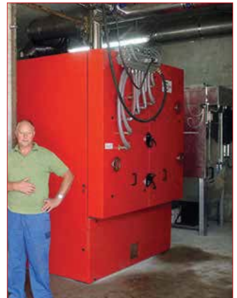
Peter Herren vor der ÖKOTHERM®- Biomasse-Heizanlage
