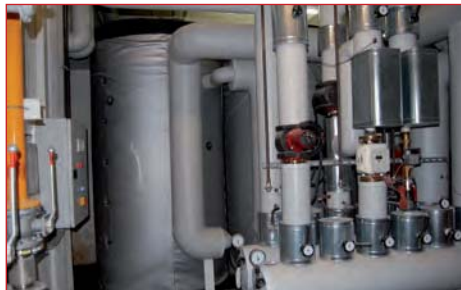
Verteilerstation und Pufferspeicher
