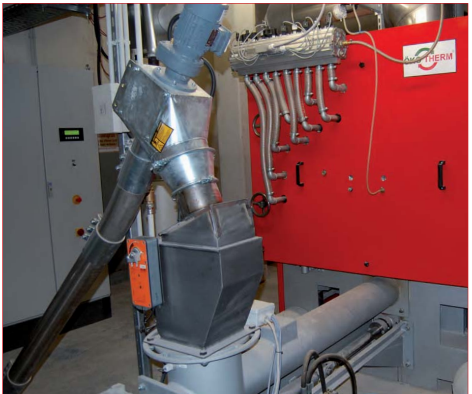
ÖKOTHERM®-Biomasseheizanlage mit 450 kW und Pellet-Spiralförderer
