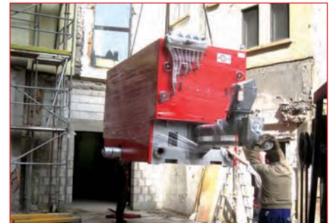
...mit sicherer Landung im Heizhaus
