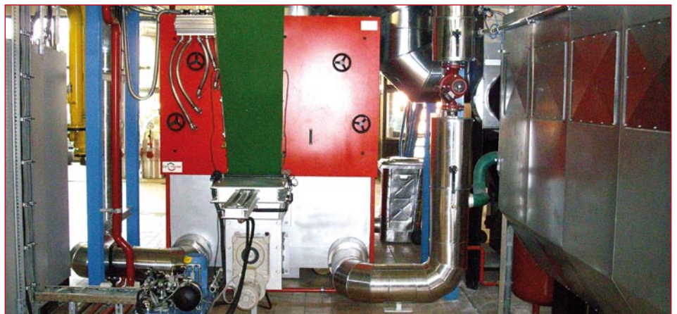
Viel Technik auf der Rückseite: Brennstoffzuführung, automatische Wärmetauscher-Abreinigung, Rauchgas-Gewebefilter (rechts)
