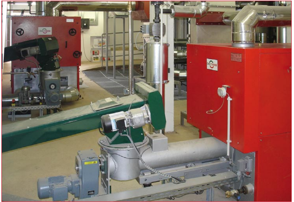
Vorbildliche Installation: Die beiden ÖKOTHERM® Heizanlagen mit 275 kW (links) und 120 kW (rechts)
